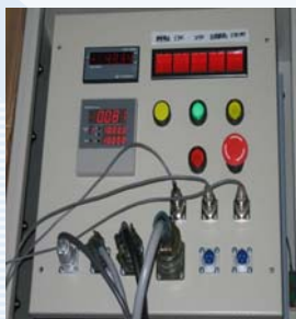
写真-3.2 制御装置
